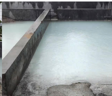
图3-3砂石分离机沉淀池
